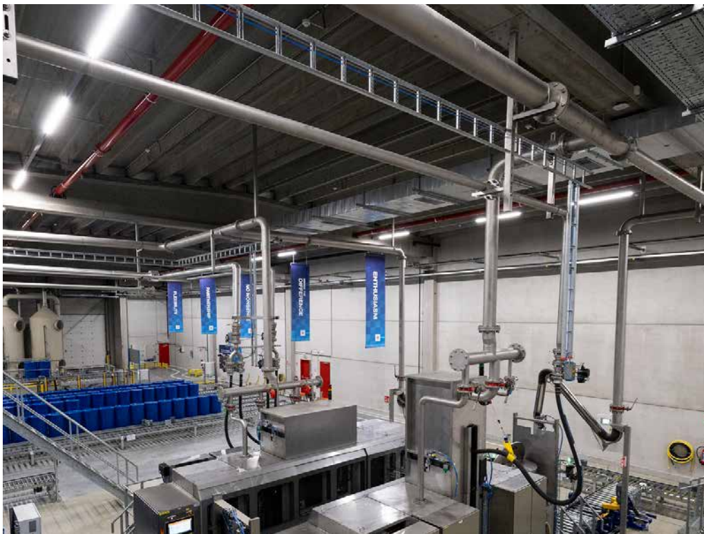
In de verwerkingshal gaat alle transport via geautomatiseerde rollenbanen: efficiënt én veel veiliger voor het personeel.
