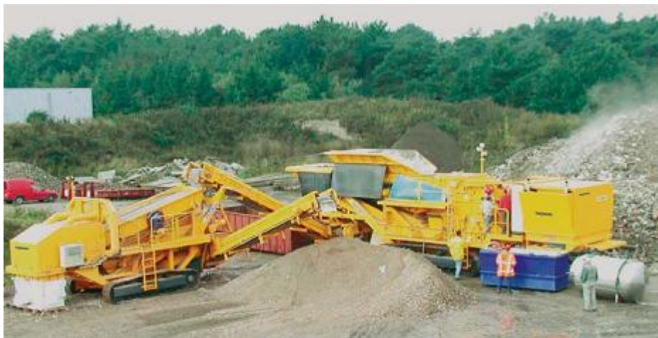
Bestaande mobiele Hazemag recycling installatie van Heijmans
